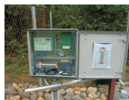
Estación de medida
