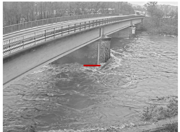
Niveau d'eau détecté de jour, pendant un événement de crue.
