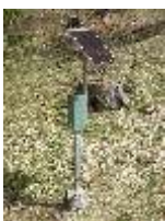
Monitoreo de aguas subterráneas
