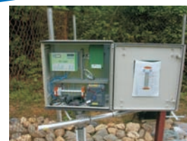
Estación de medición
